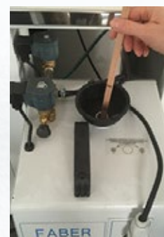
Varilla medidora de nivel de agua
